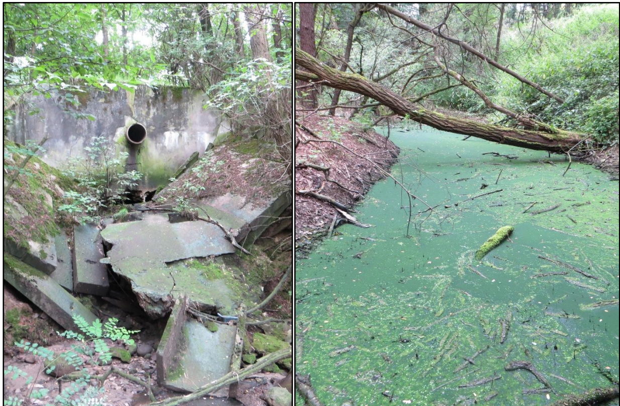
Abbildung 4 Links: eine Rohleitung, die Abwässer in das nördliche Kleingewässer leitet; rechts: als Resultat ein artenarmes, degradiertes Gewässer (Aufnahmen vom 30.07.2025)
